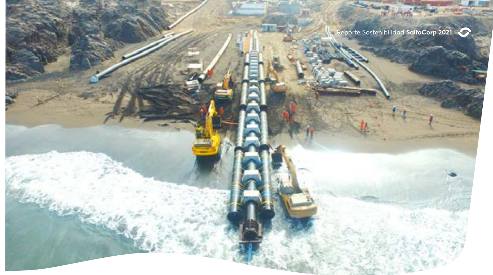
Aguas Antofagasta S.A., Obras Marítimas Planta Desaladora Tocopilla, Antofagasta, II región, Chile.
