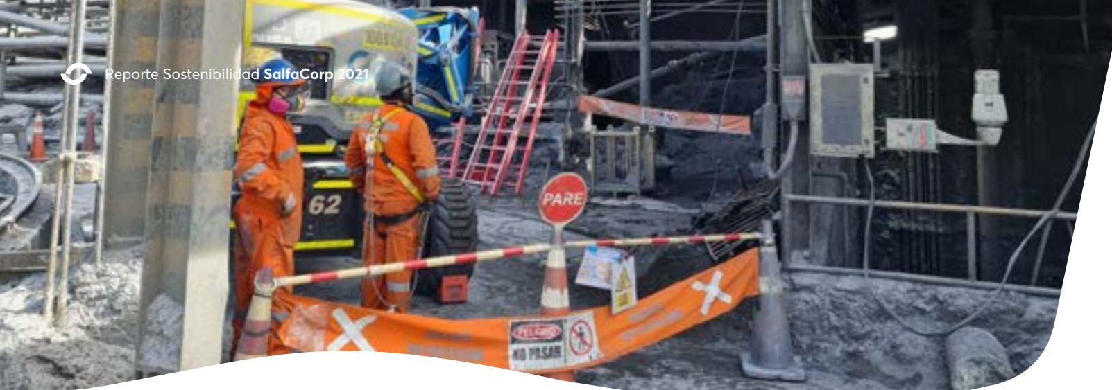
Codelco División Chuquicamata, Servicio de Mantenimiento Integral Planta de Molibdeno y Filtros, Calama, II Región, Chile.
