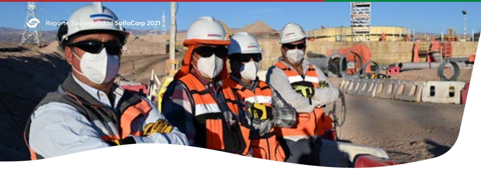
Teck, Estaciones de Bombeo - QB2, Iquique, I Región, Chile.
