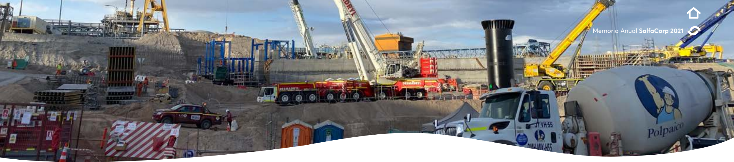
Codelco División Ministro Hales, Construcción y Montaje Tercer Espesador de Relaves, Calama, II Región. Chile.
