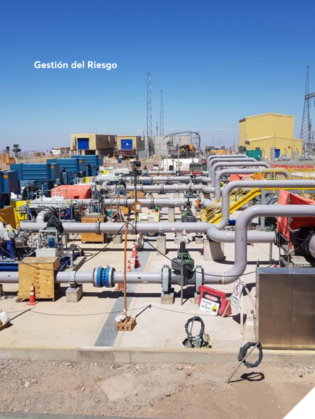
Teck, Estaciones de Bombeo - QB2, Iquique, I Región, Chile.
